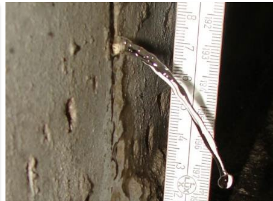
Grundwasseranstieg und Eintritt in Tiefgarage Dresden. Foto: GB1 Ingenieure
