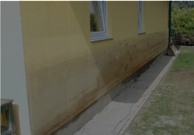
Feuchte- und Wasserschäden
