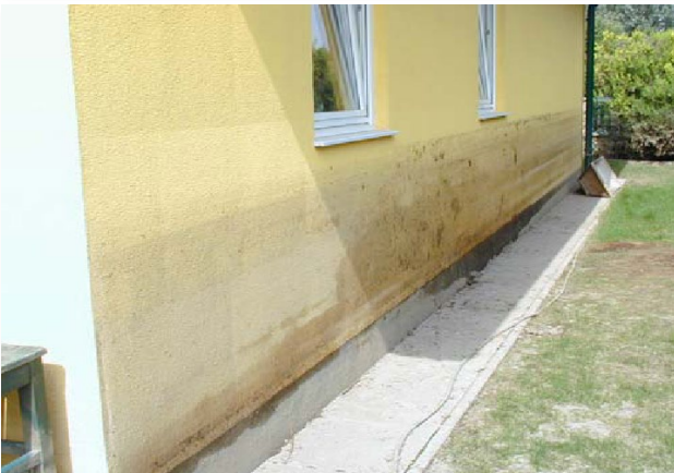
Feuchte- und Wasserschäden
