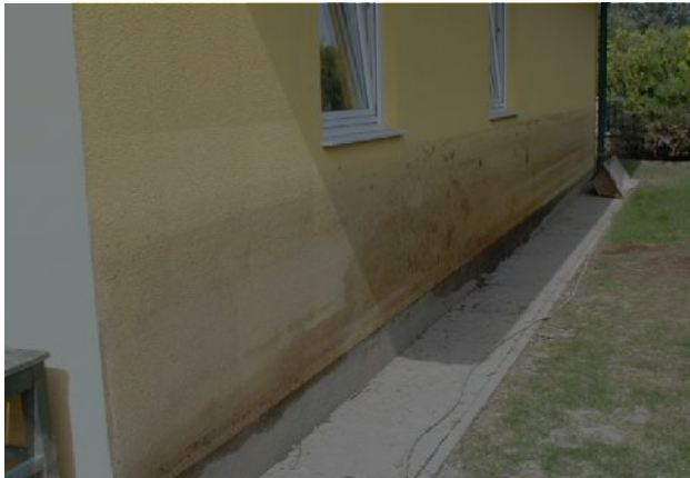
Feuchte- und Wasserschäden
