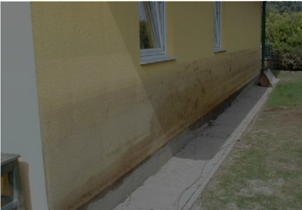
Feuchte- und Wasserschäden
