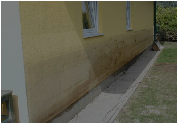
Feuchte- und Wasserschäden
