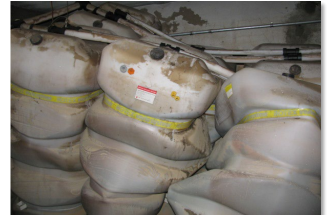
Schäden durch Kontamination
