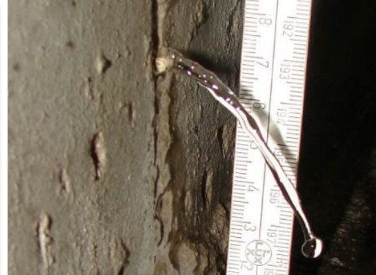
Grundwasseranstieg und Eintritt in Tiefgarage
