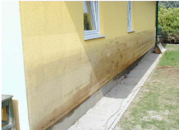
Feuchte- und Wasserschäden
